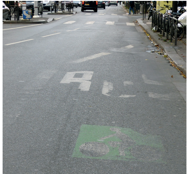
Signalisation effacée - rue de la Chapelle Paris
